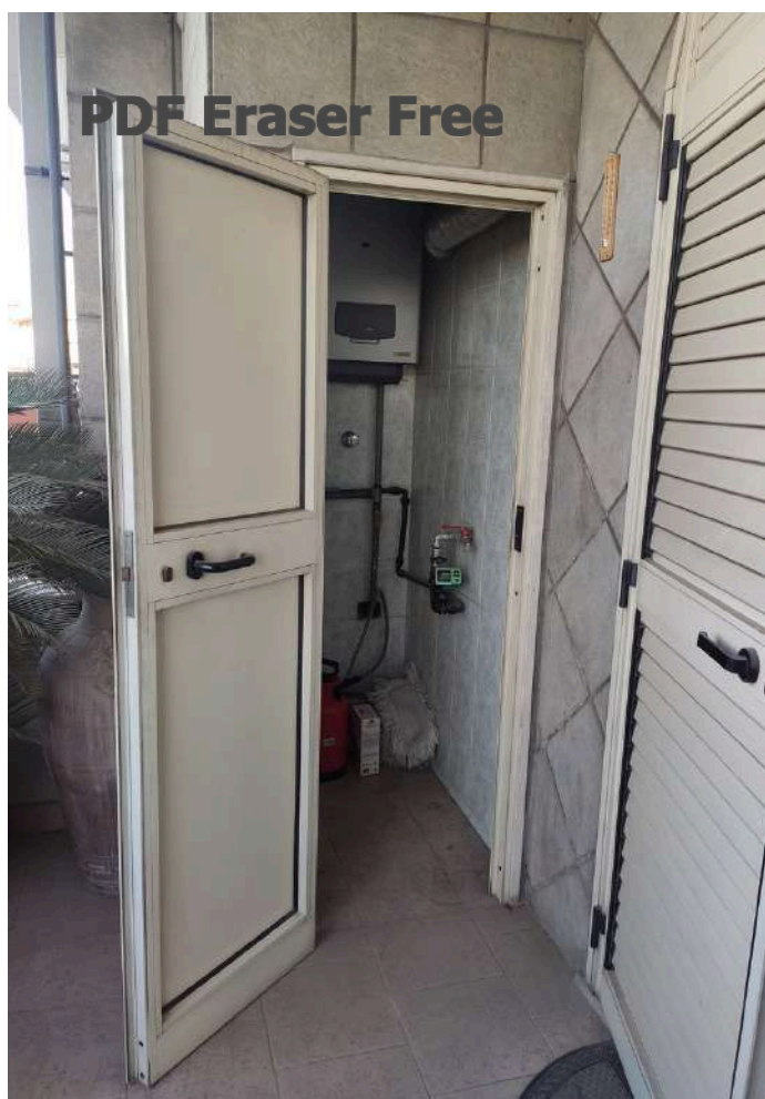
Foto 26 - Caldaia ubicata su balcone
